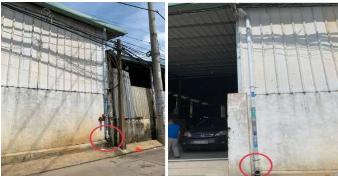
Hình 7. Vị trí ống thoát nước mưa của Công ty
