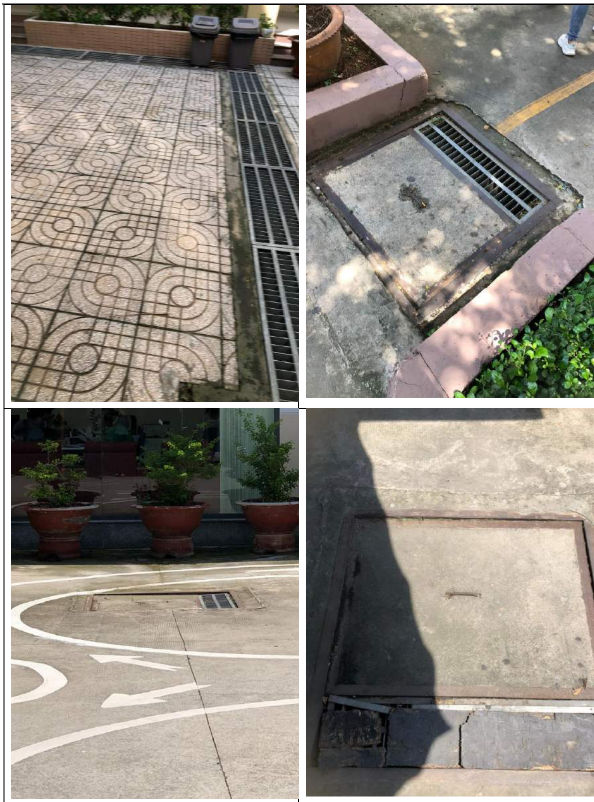
Hình 3.2. Hệ thống thu gom nước mưa tại cơ sở
