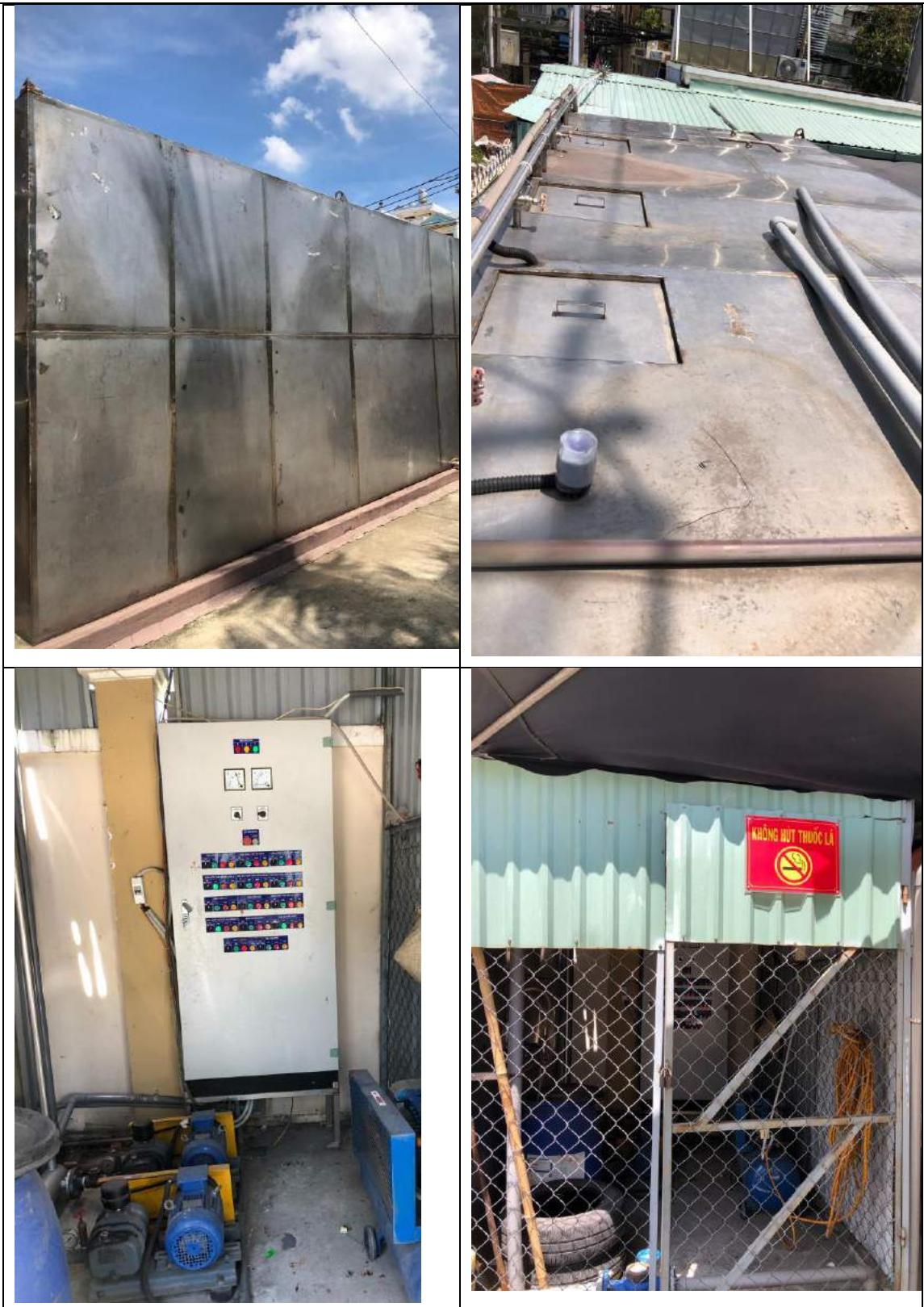
Hình 3.6. Hệ thống xử lý nước thải hiện hữu tại cơ sở
