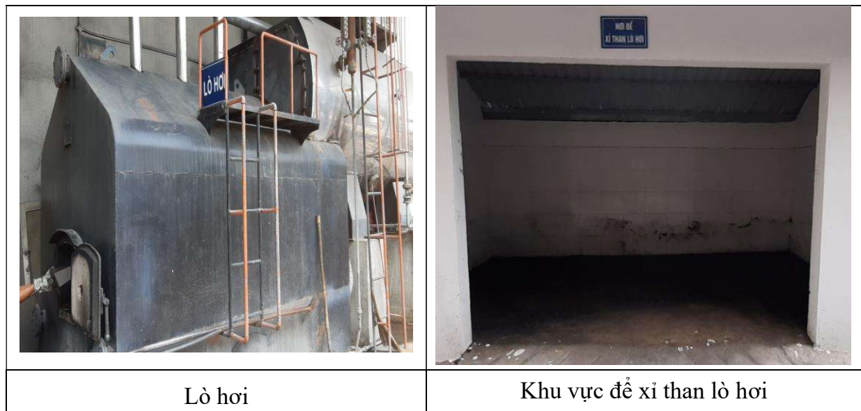
Hình 3.9. Một số hình ảnh về khu vực lò hơi
