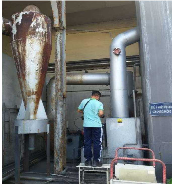
Hình 3.8. Khu vực hệ thống xử lý khí thải
