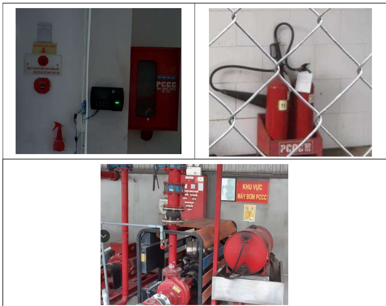
Hình 3.15. Các thiết bị phòng, chống cháy nổ của Công ty
