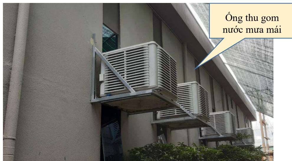
Hình 3.2. Hình ảnh ống thu gom nước mưa mái quanh khu vực nhà xưởng
