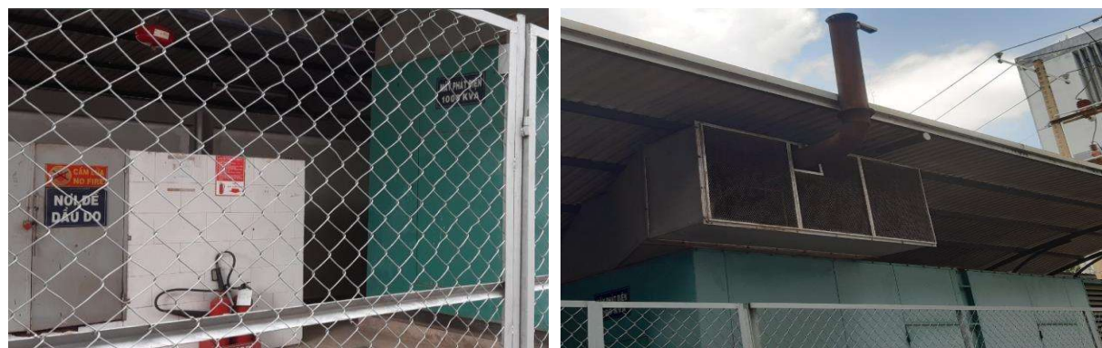
Hình 1.5. Khu vực máy phát điện của cơ sở
